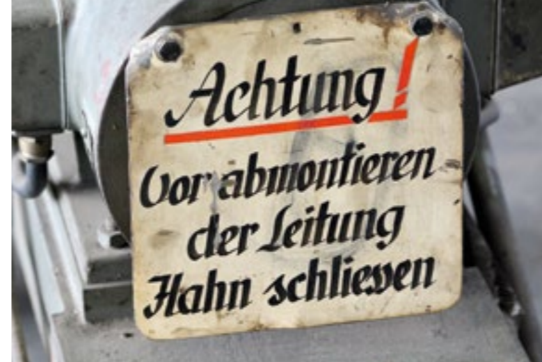
Warnhinweis an einem Luftstarter.
